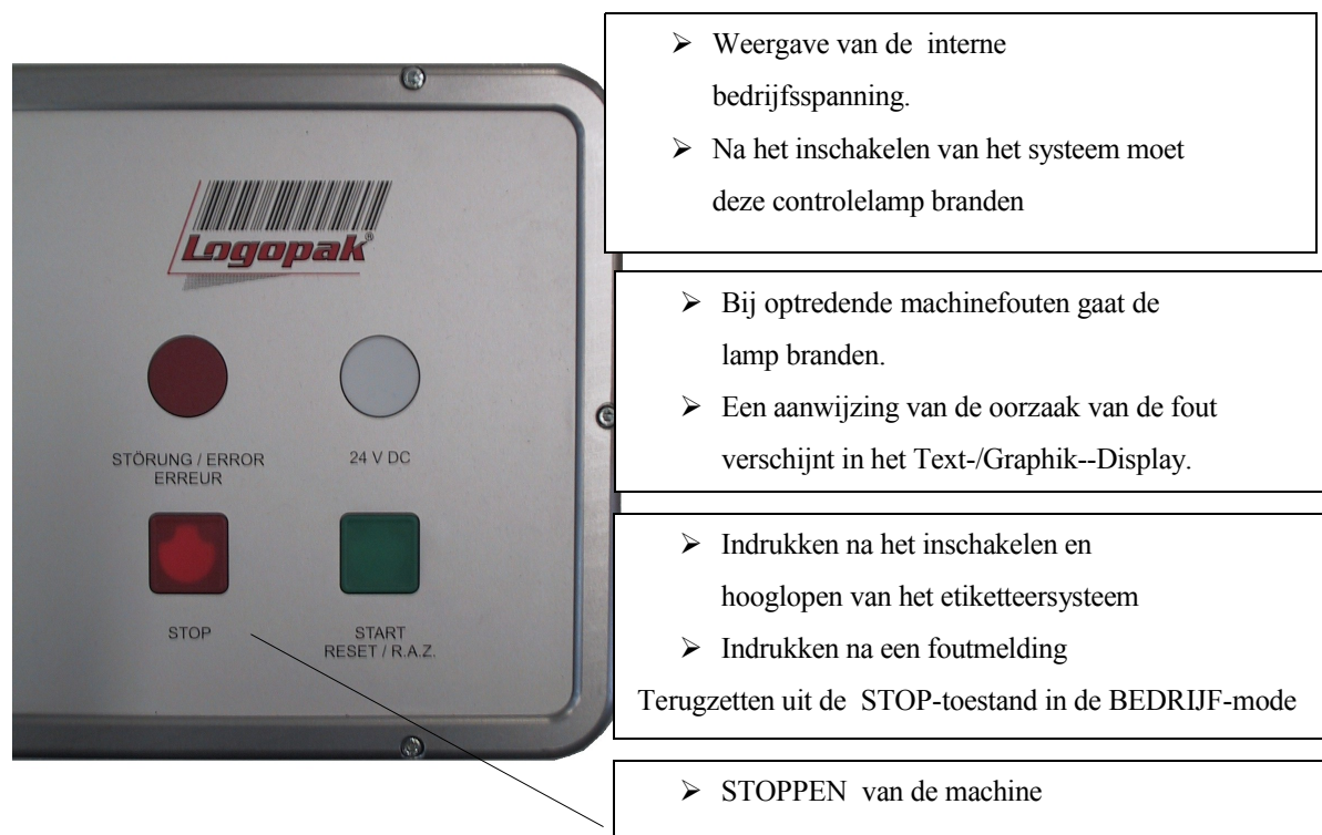
Figuur 2: Gedeelte frontplaat met controlelampen en toetsen
